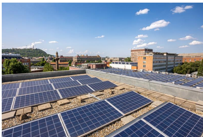
8. ábra: Napelemek a BME épületeinek tetején
